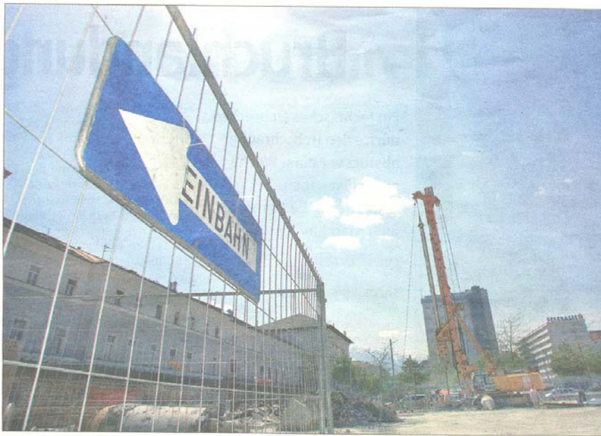
Baustelle Bahnhofsvorplatz: Hier soll ein Einkaufszentrum entstehen. Die Post-Mitarbeiter sind in einen Container übersiedelt.
